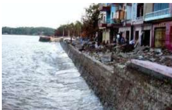
▲ Hình 8.6. Con bão số 2 năm 2005 đã phá hủy bờ kè biển kiên cố ở Đồ Sơn (Ảnh: Viện tài nguyên môi trường biển)
